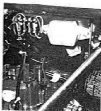
Sulakerasia Säkringdosösa Fusebox
